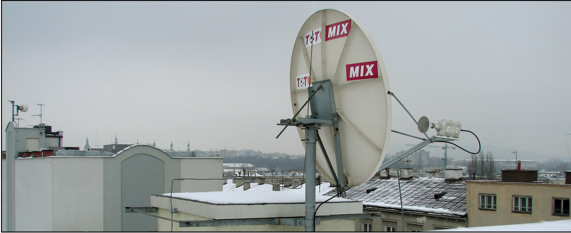
Zdjęcie 5. Antena satelitarna ze zwodem odgromowym podpiętym do konstrukcji wsporczej.
