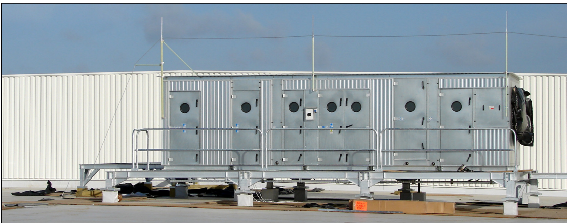
Zdjęcie 6. Zwody odsunięte typu „AntyGrom” chroniące centralę klimatyzacyjną na dachu.
